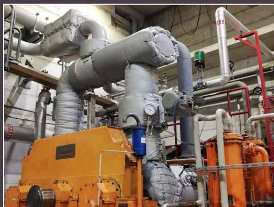
Turbina e tubazione
